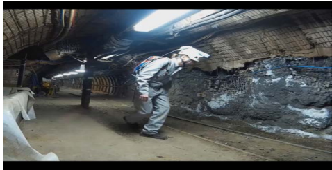
图 6 检视巷道破坏情况
